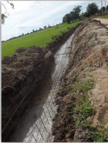
31. โครงการก่อสร้างรางส่งน้ำ คสล. รูปตัวยู หมู่ที่ 2 บ้านหนองลำโพง
